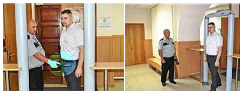
Система обнаружения металлов, установленная у входа в здание АП Кахул. Источник: АП Кахул
